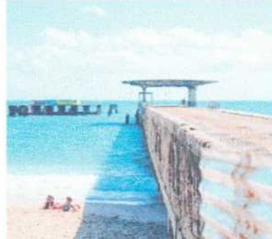
PONTE VELHA, no Poço da Draga, fechada após parte da estrutura desabar
